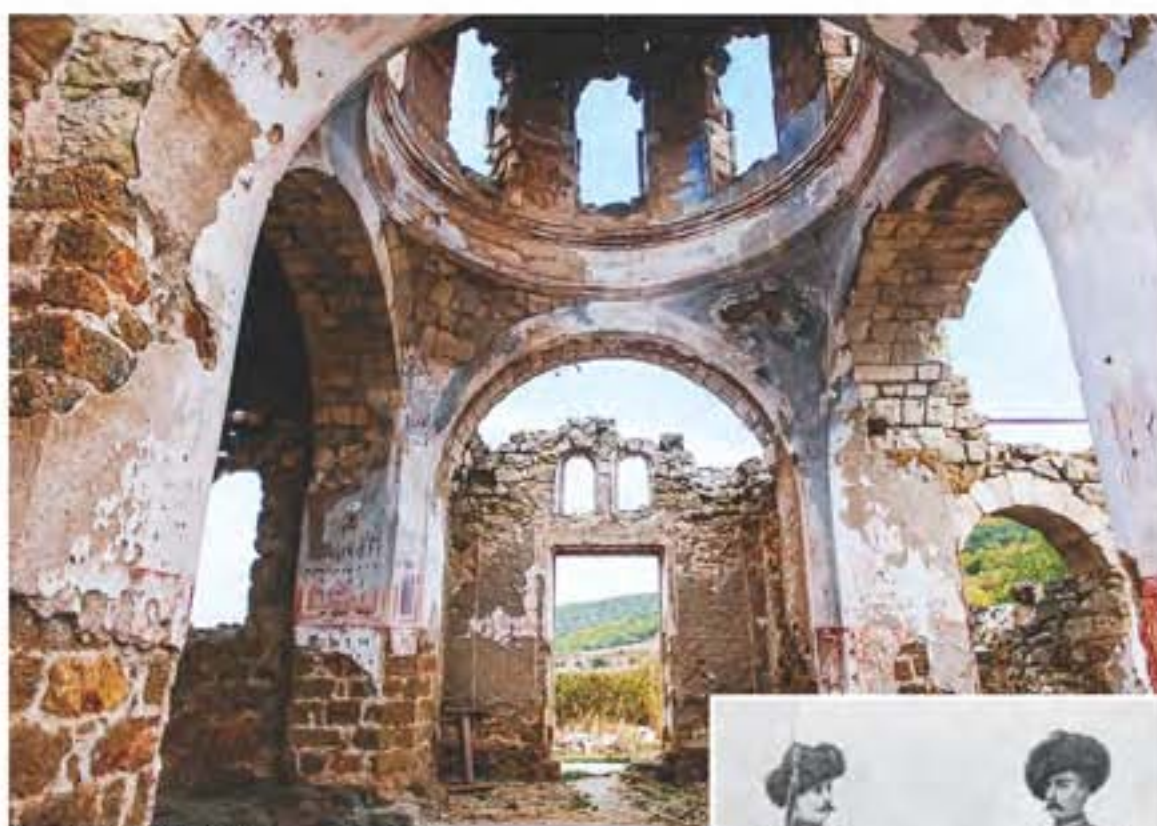
Разрушенный храм села Лаки.
