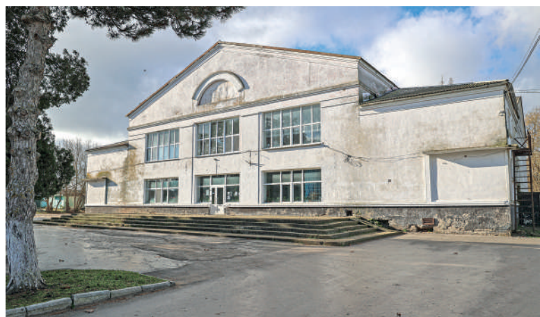
Дом культуры в ожидании ремонта.
