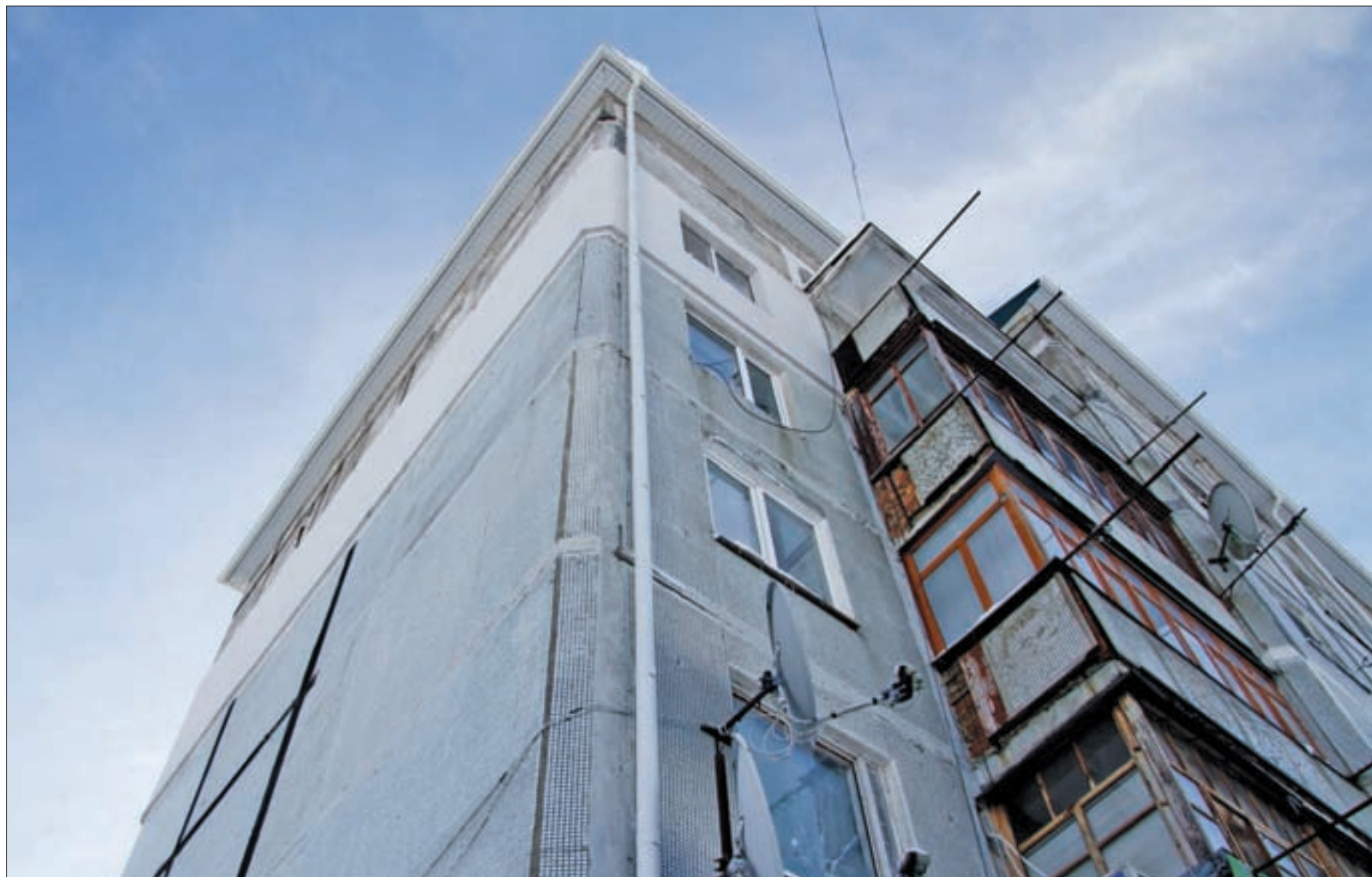
Крыши домов на ул. Ленина в пгт Зуя долго ждали ремонта.
