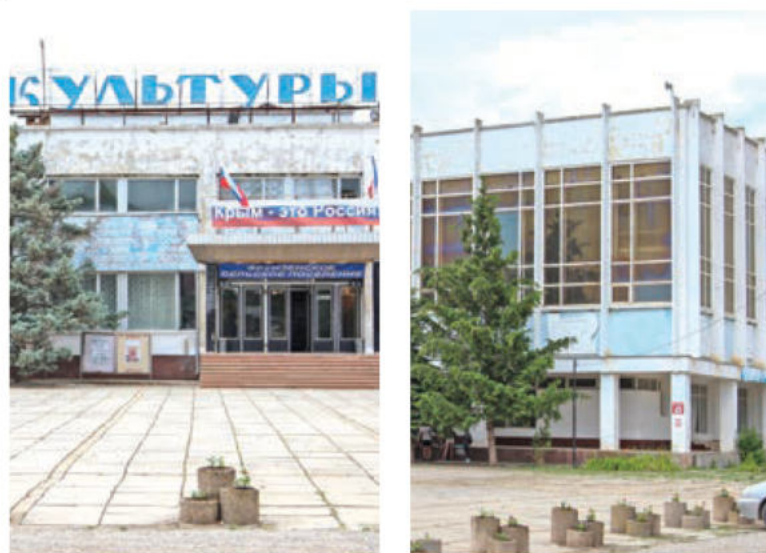
Местные Дом культуры и спорткомплекс ждут ремонта.
