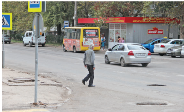
Дороги на некоторых улицах – яма на яме.
