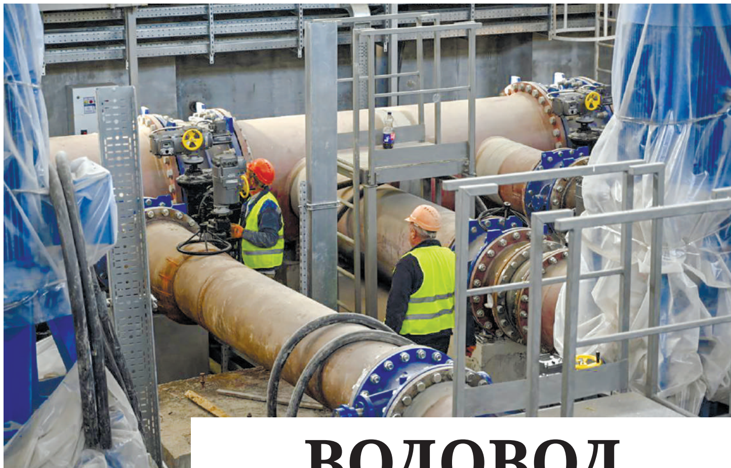
В рамках импортозамещения на насосных станциях частично установлено отечественное оборудование. Фото: Гала АМАРАНДО
