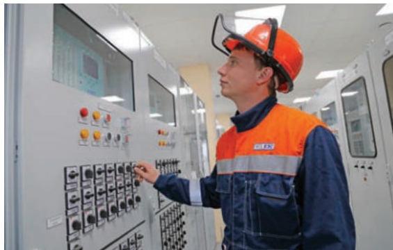
Подстанция «Кафа»: запуск последней нитки энергомоста.
