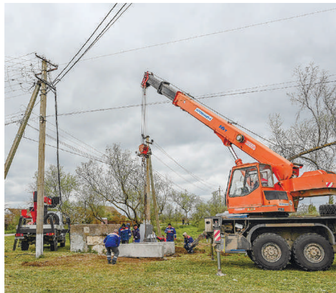
Новый трансформатор поможет решить проблему качественного энергоснабжения села.
