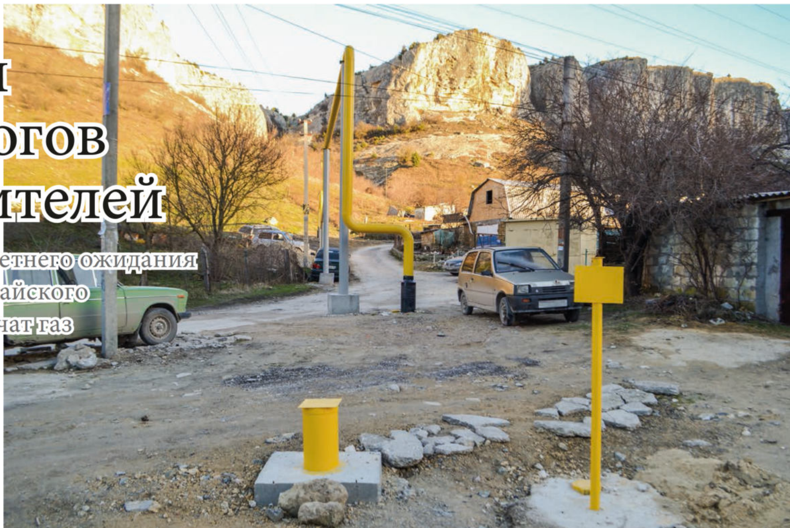
Часть газопровода проложена под землёй, часть – наземно. Фото автора
