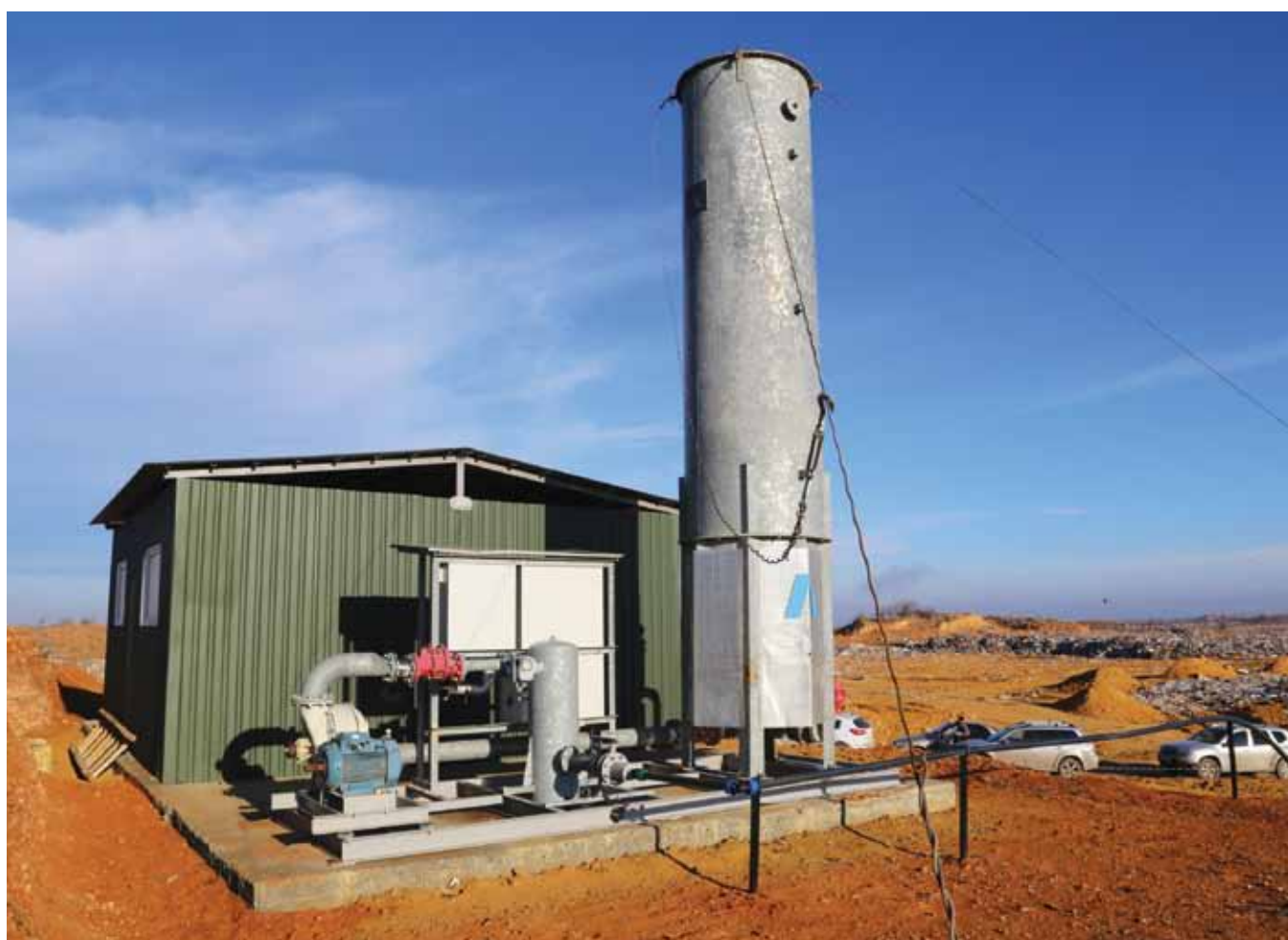
Небольшой модуль на свалочном газе позволяет вырабатывать 60 кВт в час.
