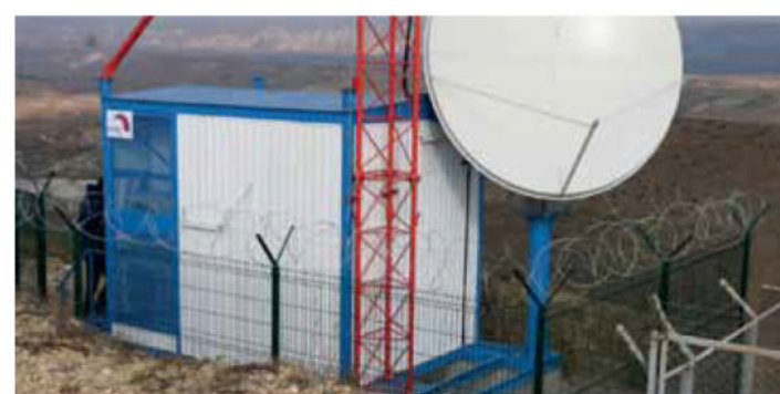
Такое антенно-мачтовое оборудование позволяет обеспечить цифровым сигналом отдалённые районы республики. Фото: klanews24.ru
