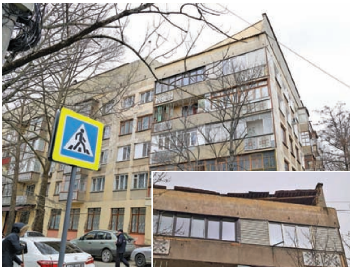
Аварийную кровлю временно укрепили листами ОСП. Опасности крыша не несёт. Фото: Лидия ВЕТХОВА
