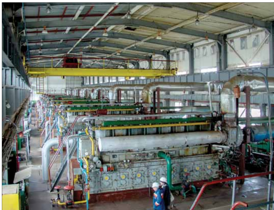
Мощные компрессоры закачивают под давлением в 53 атмосферы газ под землю.
