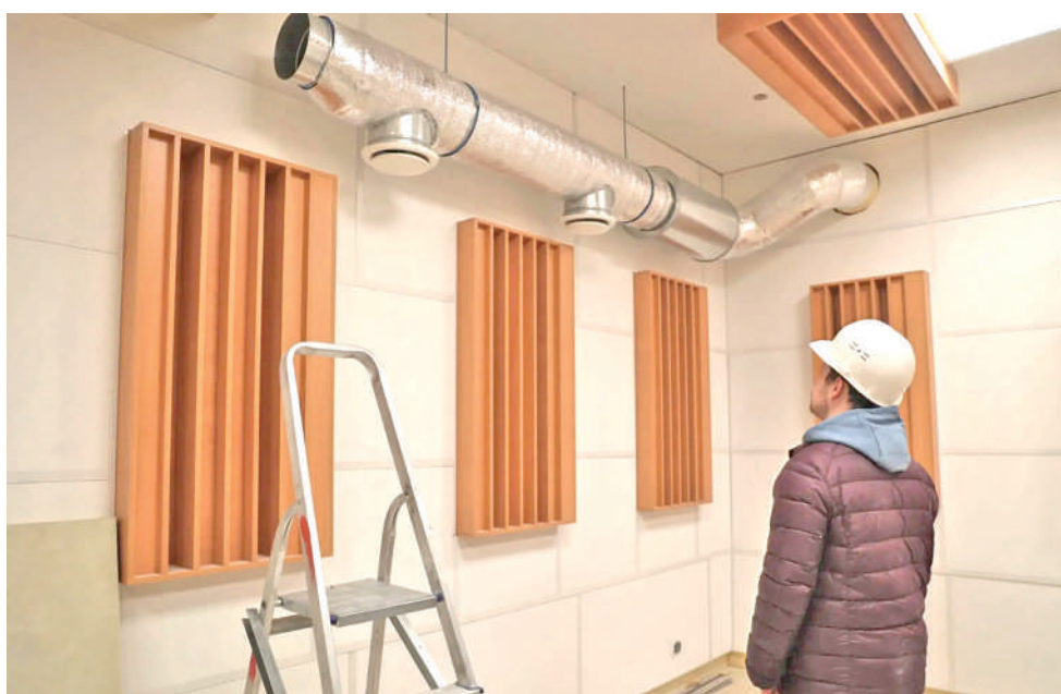
Репетиционные комнаты на 3-м этаже оборудованы звукопоглощающим покрытием и диффузорами для правильного рассеивания звука по комнате.
