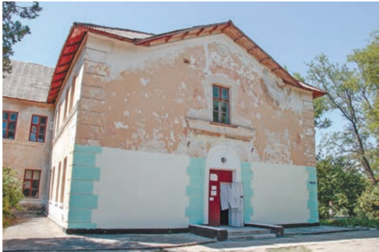
ДК в аварийном состоянии, но сроки его реконструкции пока неизвестны.
