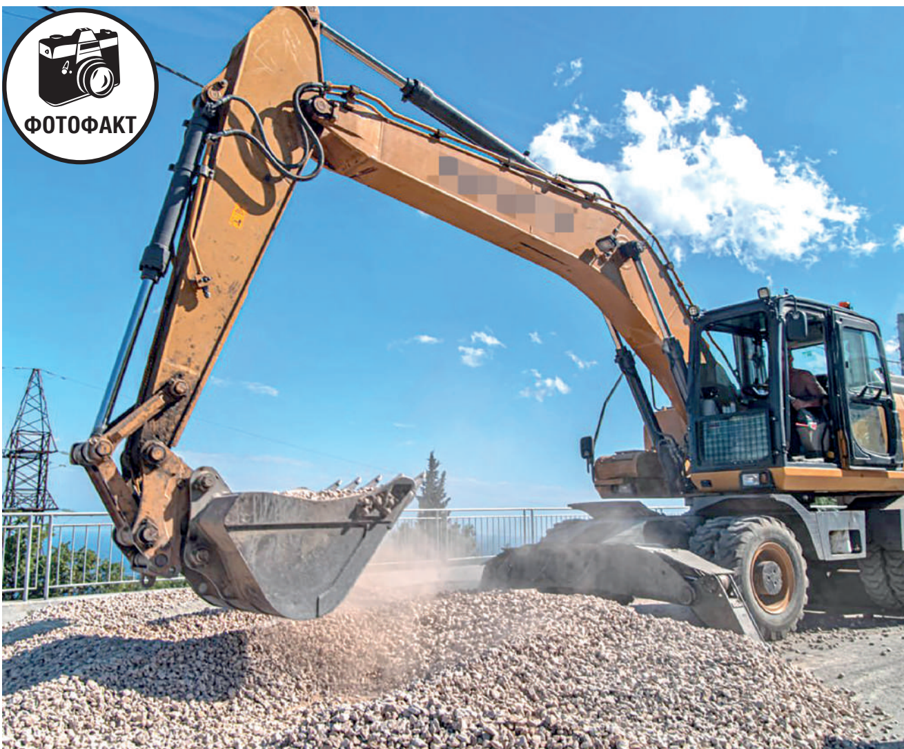
Продолжаются работы по капитальному ремонту автомобильной дороги на участке от Алушты до Ялты. Фото Михаила ГЛАДЧУКА.
