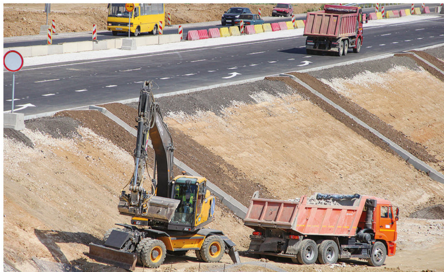
Капитальный ремонт новых дорог по обновлённому нормативу возможен только через 24 года. Фото из архива газеты
