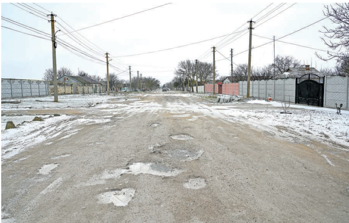
Плохое состояние дорог – основная жалоба местных жителей.
