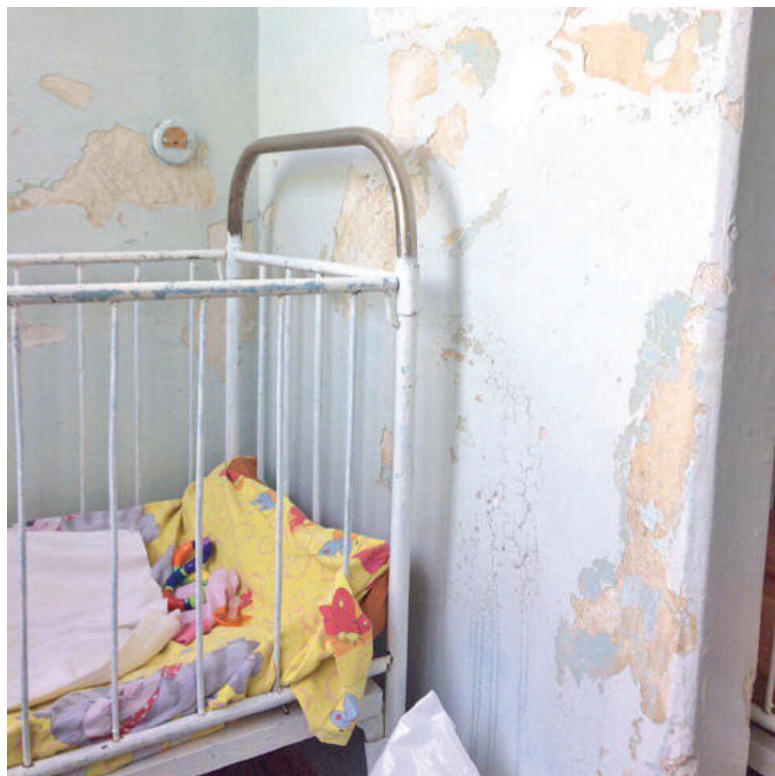
Со стен в отделении сыплется штукатурка.
