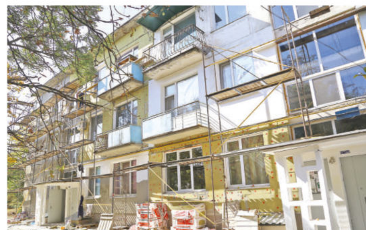
Капремонт только начали, в сельсовете объясняют: дома в относительно хорошем состоянии.
