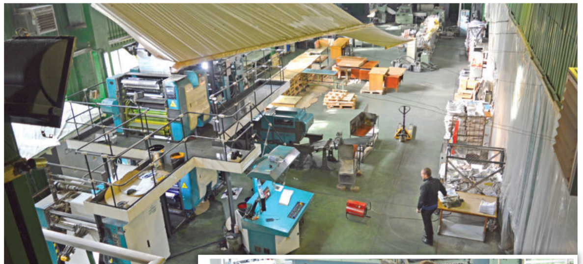
Козырёк от дождя, установленный над оборудованием газетного цеха, – способ продолжать бесперебойную работу.
