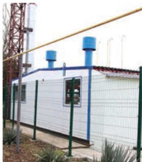
Автономная котельная мощностью в один мегаватт сможет отапливать и здание Кировской средней школы, и помещения модульного детского сада.
