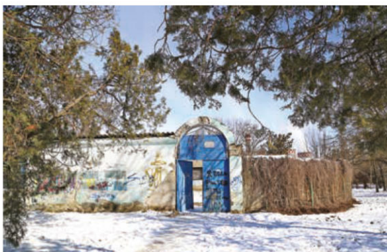
Несмотря на то что парк реконструируют, эта разрушенная площадка на его территории, похоже, в таком виде и останется.
