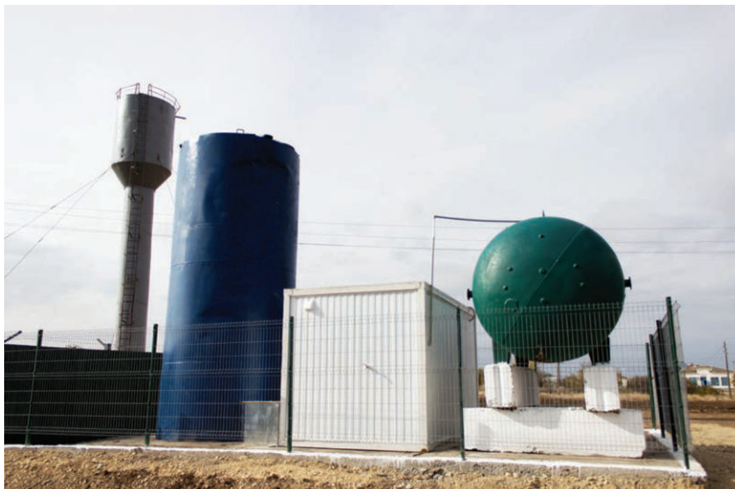
Опреснительная установка позволит жителям Каменки пить чистую воду. Фото: Михаил Гладчук
