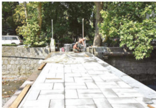
Пешеходные мосты в центре Ялты обновляются. Их построили в 1970-х XX века, и с тех пор работы по их укреплению и капитальному ремонту не проводились.
