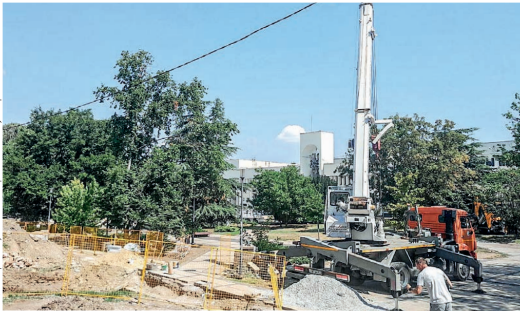
Фото: пресс-служба ГУП РК «Крымтеплокоммунэнерго»
