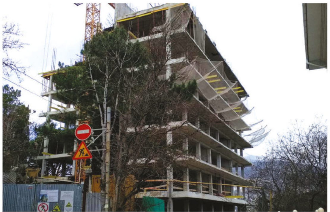
Несмотря на солидный список нарушений, «чайный дом» на улице Таврической в Ялте продолжают строить. В Минстрое Крыма произвол грозят быстро пресечь. Фото: Крымское информационное агентство
