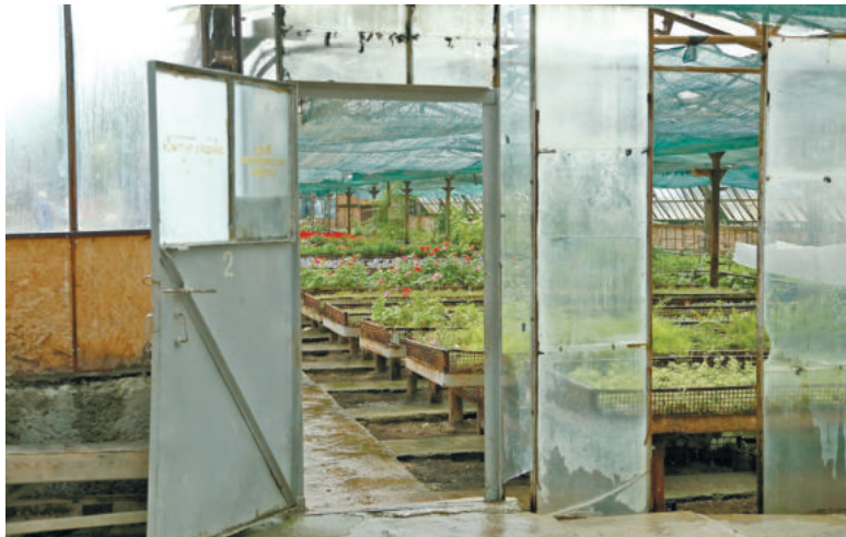
Теплицы МУП требуют ремонта. Фото Лидия ВЕТХОВА
