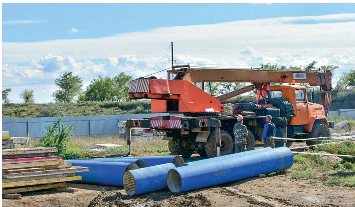
Насосная станция, Ленинский район. С. Останино.
