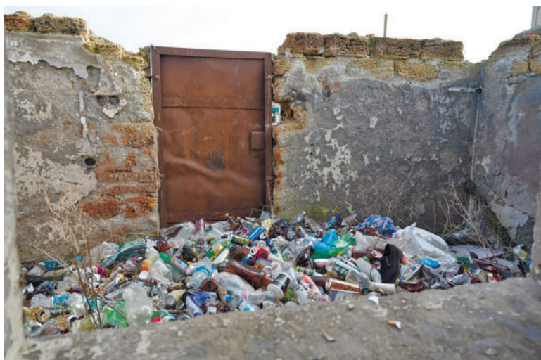
Стихийная свалка внутри одной из остановок.
