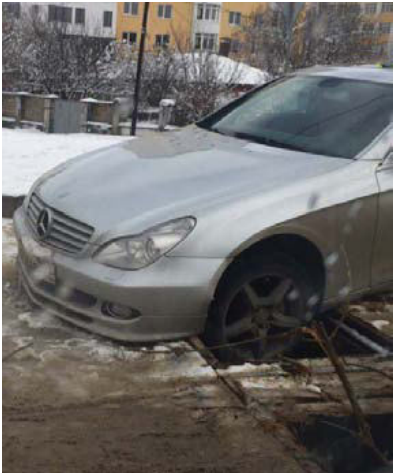
Симферополь, ул. Будённого. Ежедневно в эту яму попадают десятки автомобилей, пострадали здесь и авто сотрудников «Крымской газеты». Однако ответственные за эту дорогу проблему будто не замечают.
