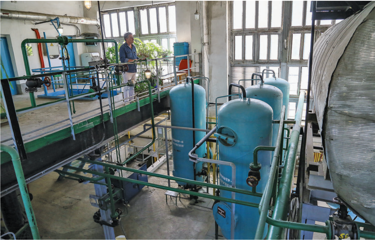
18 сентября, г. Симферополь. Старший мастер котельной Центрального района Андрей Емельянов говорит, что вверенный ему участок к отопительному сезону готов. Фото: Лидия ВЕТХОВА
