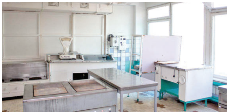
Половина оборудования кухни школы не работает уже несколько лет.
