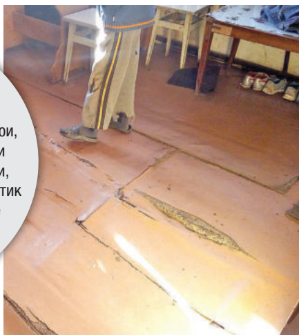
В домах Шараповых и Кравченко нужен капитальный ремонт.
