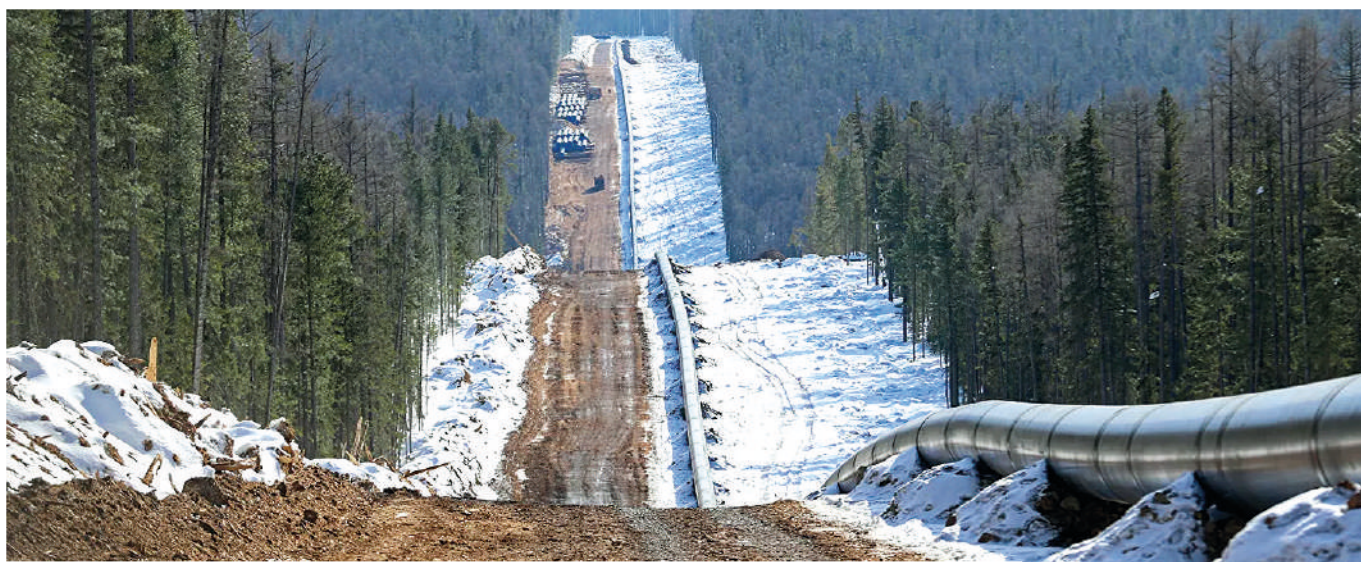
Газопровод «Сила Сибири» уже поставляет природный газ в Китай. Планируется строительство второй очереди. Фото: ПАО «Газпром»
