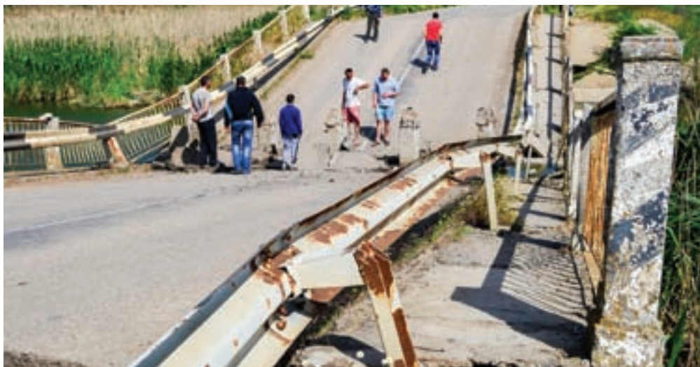
Обрушившийся мост через реку Победная в Джанкойском районе.
