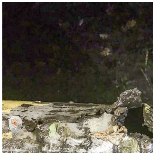
При осмотре места происшествия специалистами было обнаружено внешнее повреждение линии газопровода. Фото: Национальный антитеррористический комитет
