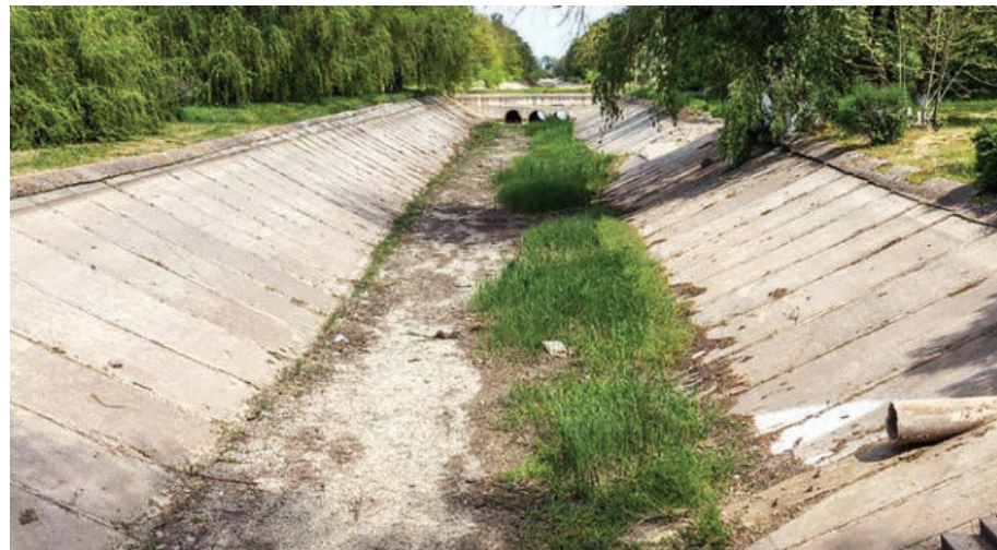
В разрушенном состоянии Северо-Крымский канал может представлять экологическую угрозу
